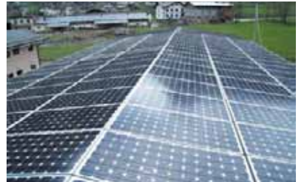
Impianto fotovoltaico SolarElit
